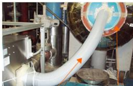
処理出口部より除湿乾燥空気を 低圧給水加熱器へ送風 低圧給水加熱器
